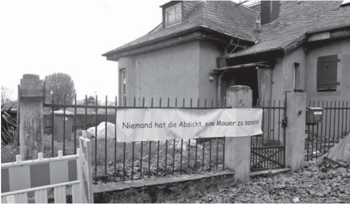
Ein Kleinod wird zum Schandfleck. Das Ensemble Stadtmauer/Fährhaus gehört eigentlich zu den Attraktionen, mit denen Höchst glänzen kann, beziehungsweise könnte. Zwar wurde mit zahlreichen Maßnahmen dafür gesorgt, dass eventuell herabstürzende Steine keine Gefahr für Fußgänger darstellen, aber der Anblick der bröckelnden Mauer und des stetig verfallenden Fährhauses ist mehr als trostlos. Der Ortsbeirat 6 drängt den Magistrat nun zu einer Stellungnahme, zumal das Jubiläum der Höchster Fähre bevorsteht. Zu deren 400-jährigem Bestehen sollte auch die Umgebung einen entsprechenden Rahmen bilden. Foto: Mingram
