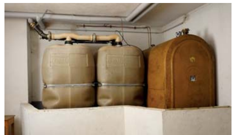
Wer sich von der Ölheizung trennt, kann auch auf die alten Öltanks verzichten und gewinnt einen Kellerraum. Foto: djd/E.ON
