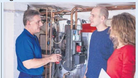
Der Austausch von Pumpen wird seit August 2016 gefördert - das BAFA erstattet 30 Prozent der auf der Rechnung aufgeführten Kosten. Foto: djf/Intelligent heizen/VdZ
